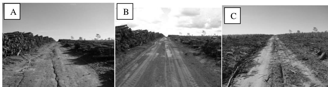
FIGURA 4: Estágio inicial ( muito pobre ), inspeção antes do transporte (A); Estágio de intervenção ( pobre ), inspeção antes do transporte (B); e estágio final ( muito pobre ), inspeção após o transporte (C).
