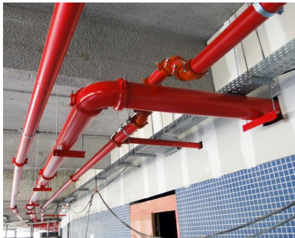
Figura 3 - Uso da solução para linhas de combate a incêndio.
