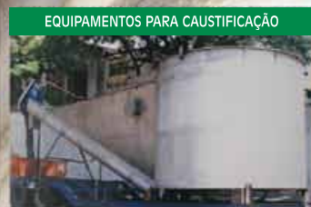
EQUIPAMENTOS PARA CAUSTIFICAÇÃO
