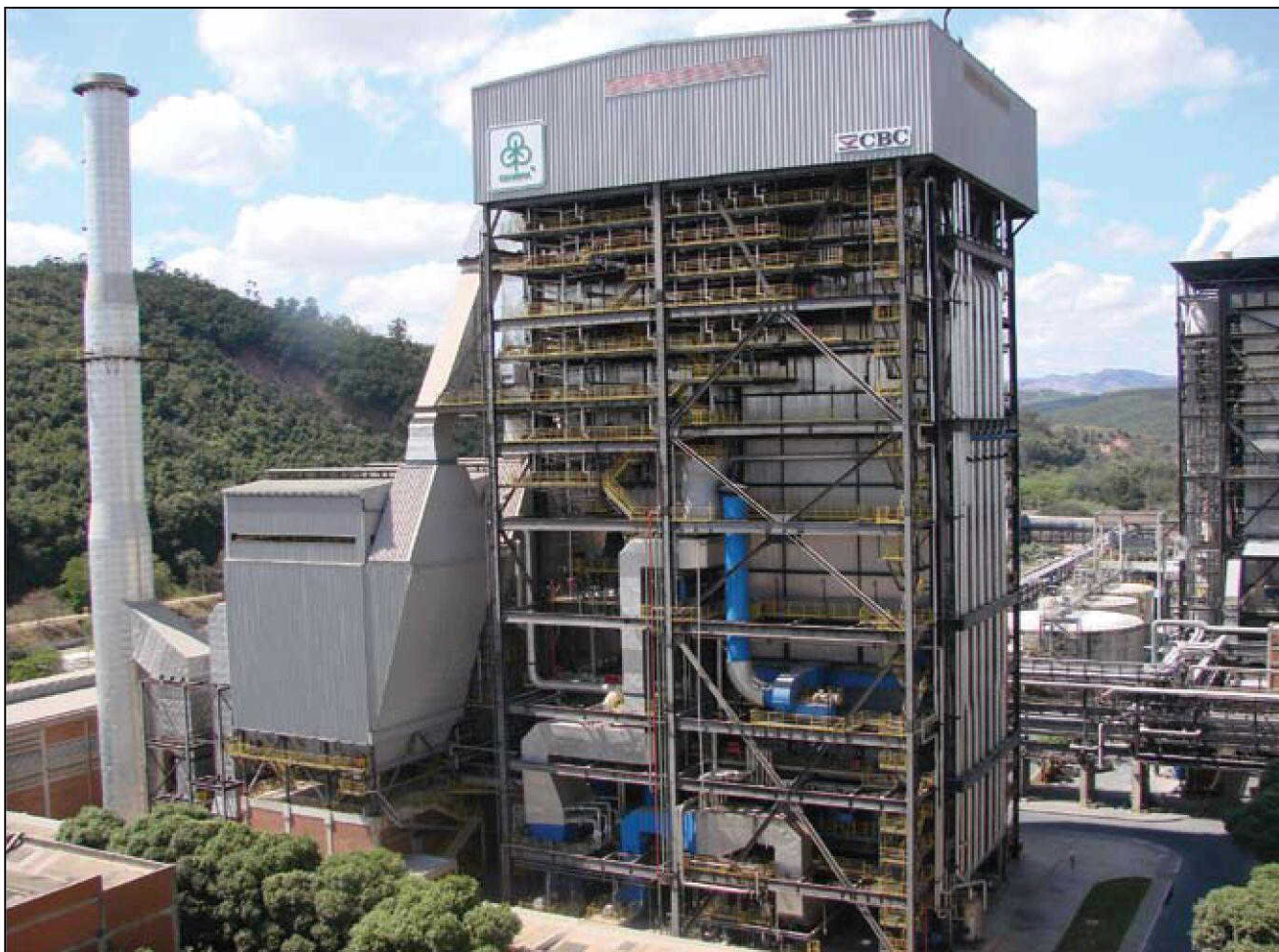
Caldeira de Recuperação 3 da Cenibra
