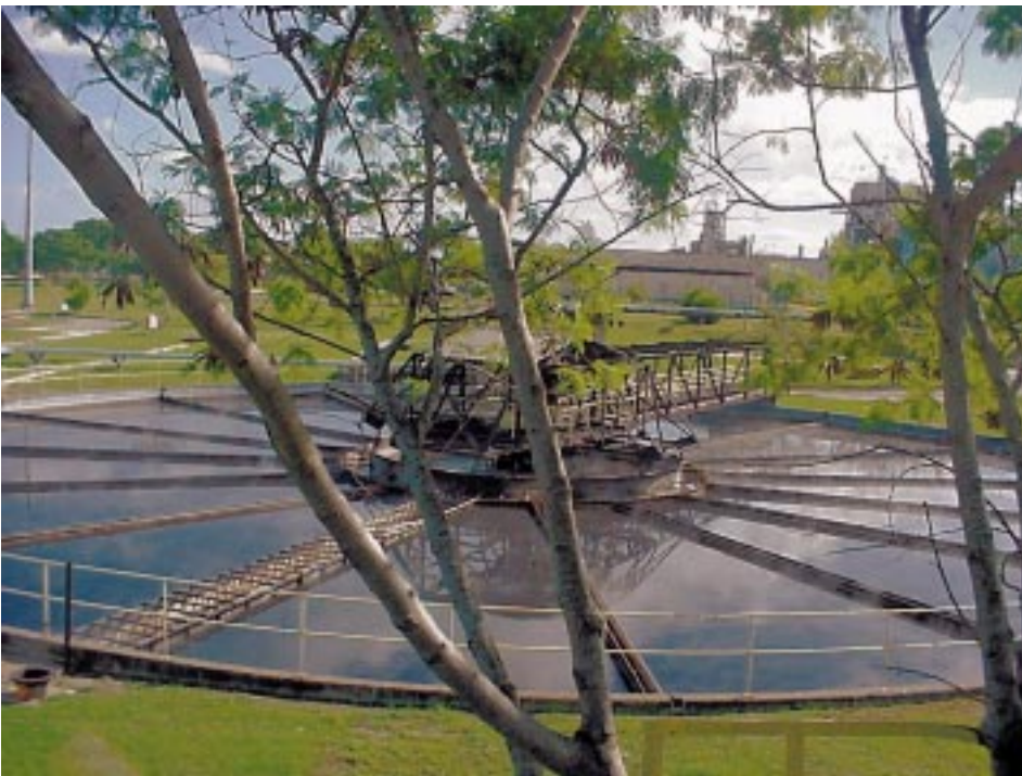
Figura 1 – Decantador do Sistema de tratamento primário da ETE da Aracruz Celulose S/A.
