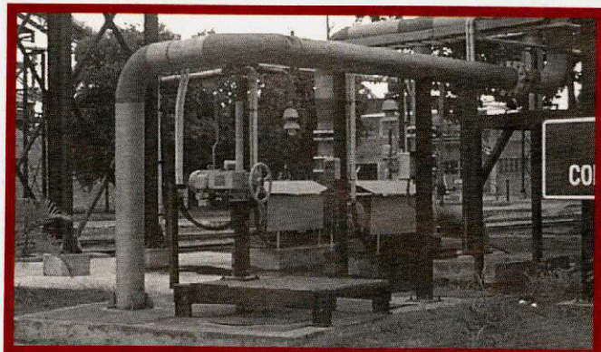
Figura 6 - Tanque de Coleta, Sistema de Bombeamento e Comporta Elétrica
