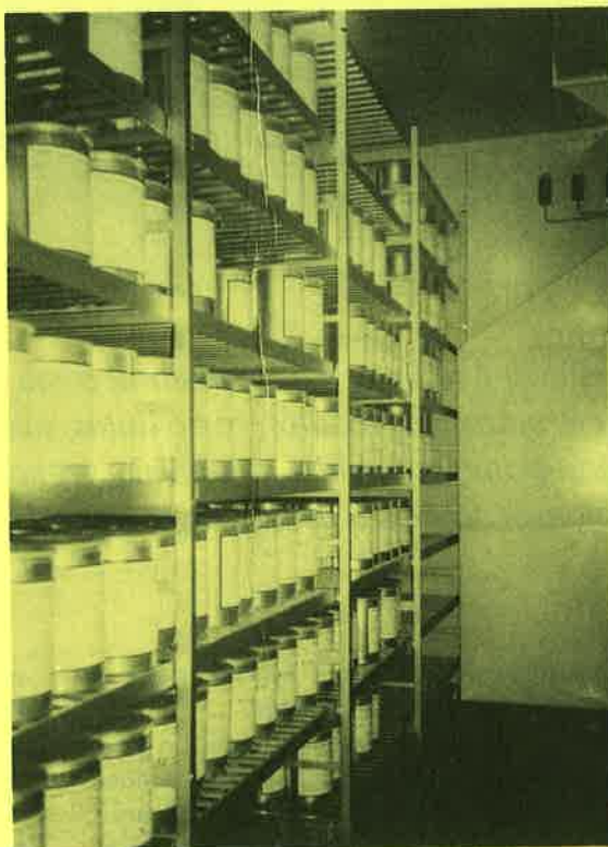
Câmara de refrigeração necessária para o armazenamento das sementes.
