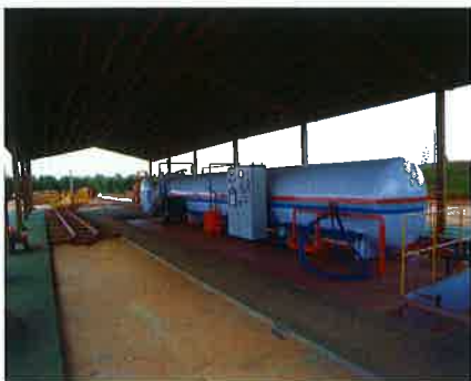
Unidade de preservação de madeira
