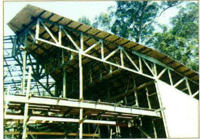
Foto 4 - Detalhe da estrutura da cobertura composta por treliças. Esta estrutura possui um balanço de 5,70m com o pé-direito máximo de 6,50m.
