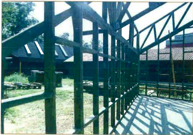
Foto2 - Através do "esqueleto" do Prédio III, observa-se diferentes tipos de cobertura: telhas cerâmicas no Prédio I e "shingles" asfálticos com iluminação zenital no Prédio II.
