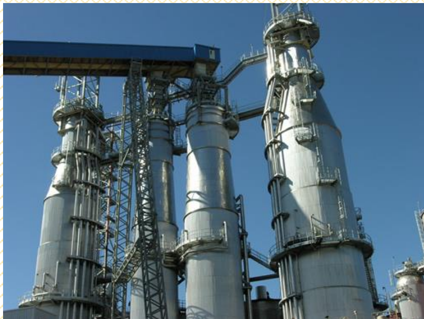
Modernos digestores contínuos da fábrica de celulose de mercado da CELCO – Nueva Aldea
